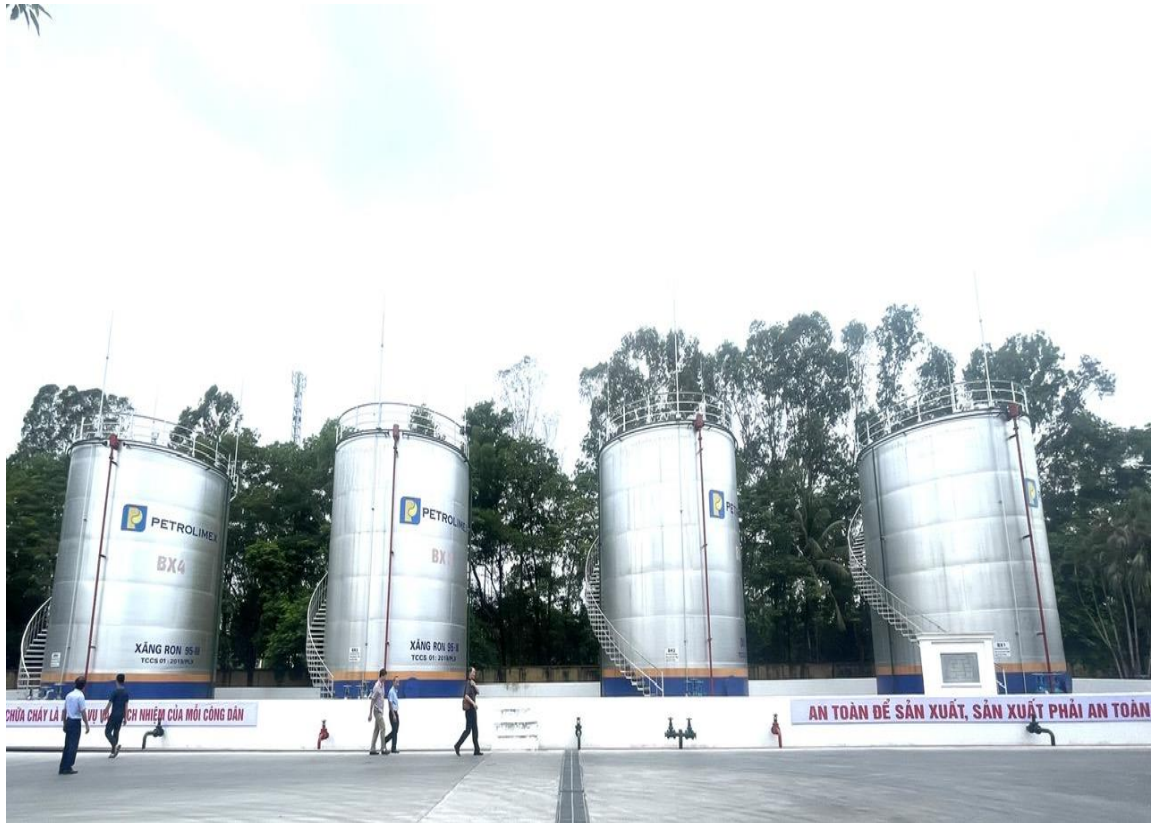
Hình ảnh: Bể chứa xăng dầu tại Bến xuất K135 Chi nhánh xăng dầu Hà Nam
